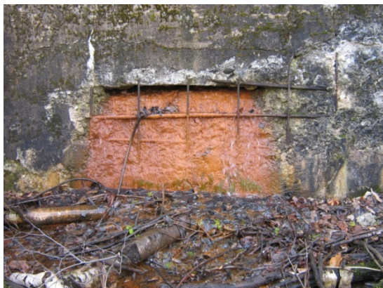
Figure 4 : Désagrégation avec une zone de fuite
