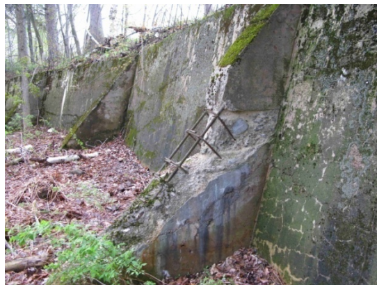
Figure 5 : Désagrégation du béton des contreforts
