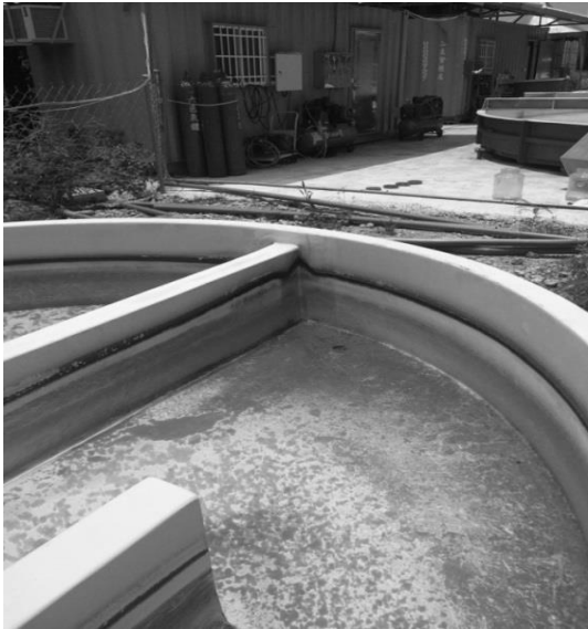
圖 4-7 現場一號彎道死水區淤積情形
