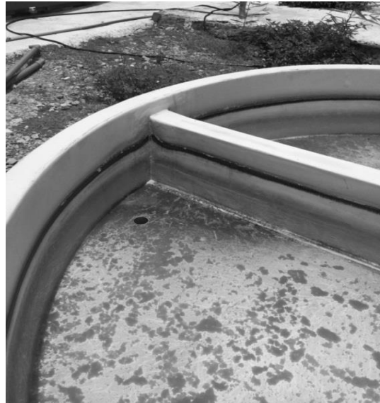
圖 4-8 現場三號彎道死水區淤積情形
